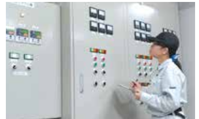
空調設備運転実習
