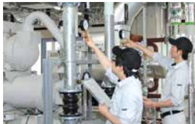
空調設備運転実習
