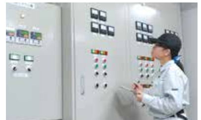
空調設備運転実習
