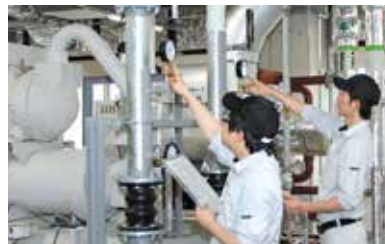
空調設備運転実習
